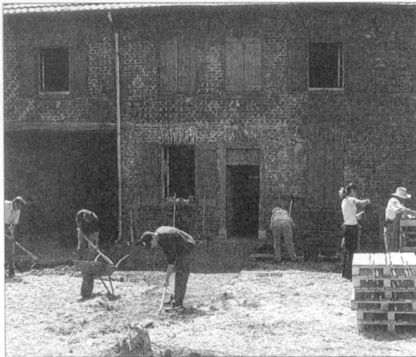
Aufräumarbeiten Hand in Hand: In Hof der ehemaligen Synagoge in Rödingen bergen Mitglieder des Fördervereins alte Steine und Ziegel als authentisches Baumaterial. Foto: Jagodzinska
