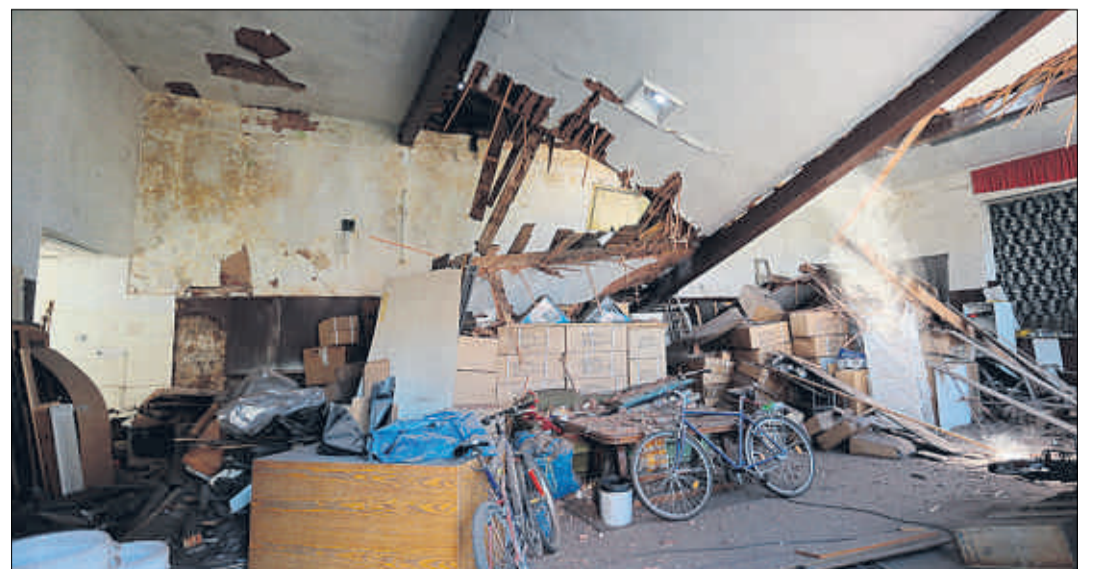
Weil der heruntergerutschte Dachstuhl sich weiter bewegte, war es nicht mehr möglich, Gegenstände aus dem als Lager genutzten Saal herauszuholen. Das Gebäude drohte auf die Gleise zu kippen. (Foto: Hilgers)
