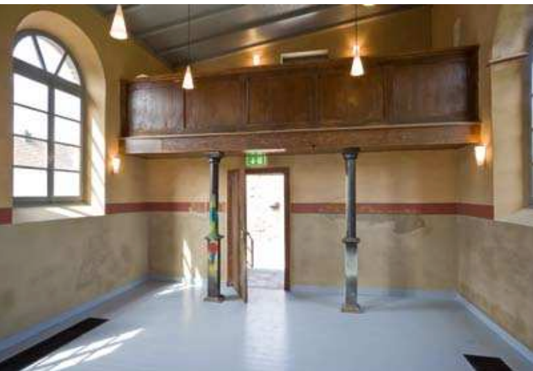
22. Synagoge, Blick auf die Frauenempore nach Instandsetzung. Foto: Andreas Schiblon, LVR-Zentrum für Medien und Bildung, 2008.
