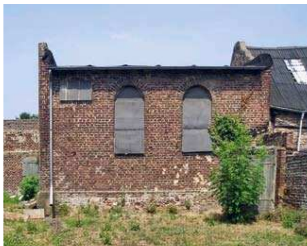
5. Synagoge vor Instandsetzung. Foto: Jürgen Gregori, LVR-ADR, 2000.
